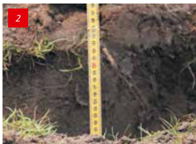
2 Creusez une tranchée de 125 cm de profondeur et de 20 à 30 cm de largeur. Assurez-vous que le fond de la tranchée est égalisé.
