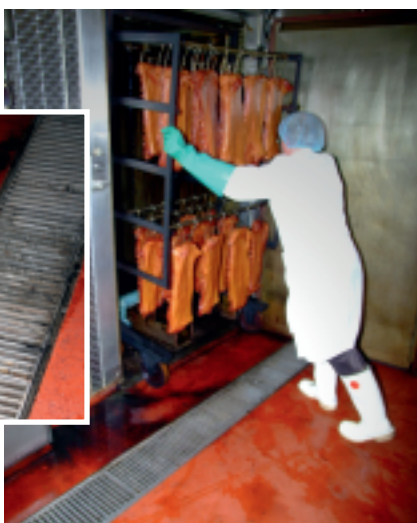
Des canaux à grilles ont été choisis pour le département hébergeant les cellules de fumage/de rôtissage/de cuisson.
