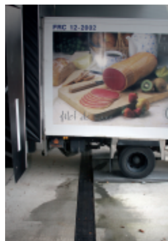
Des canaux en béton à polyester avec des grilles en fonte ont été installés près de la station-service et des quais de chargement et de déchargement.
