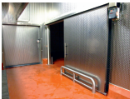
ACO Passavant a livré 65 poteaux butoirs et 15 barrières empêchant aux véhicules de transports et aux chariots élévateurs de cogner les portes et les murs.
